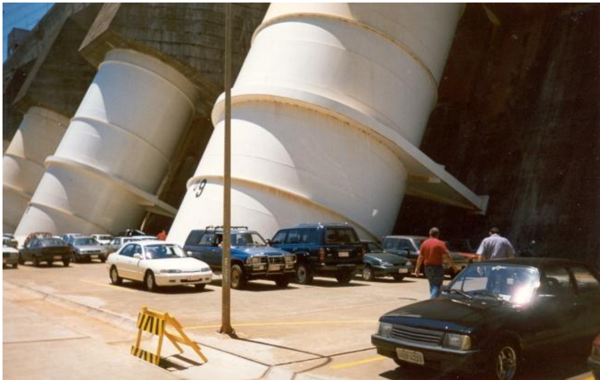
Foto bagian dasar tempat turbine berada. Pipa putih adalah inlet/jalannya air masuk ke turbin
